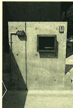
あえて露出した配管
